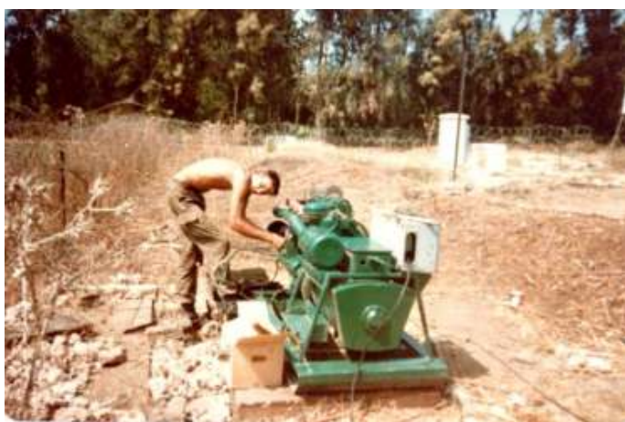
Jeroen Cox met een aggregaat Lister type 3080 met 21 Kw vermogen geplaatst op post 7-22.
